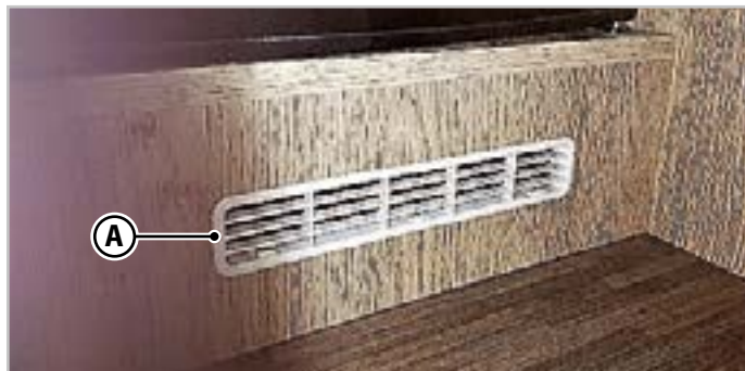
Sl.6.1 – Stalne prezračevalne odprtine
