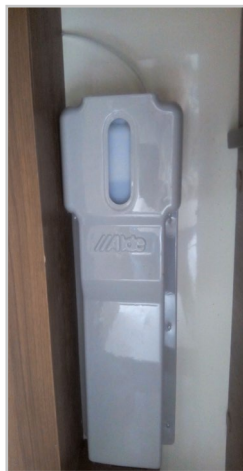
Fig.6.41 - Niveau du mélange de glycol
