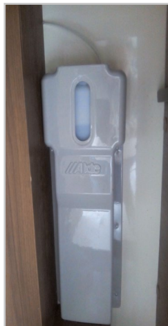
Abb.6.41 - Füllstand der Glykolmischung
